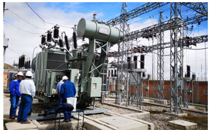
Figura 2. LISA en transformadores de potencia. Fuente propia.
