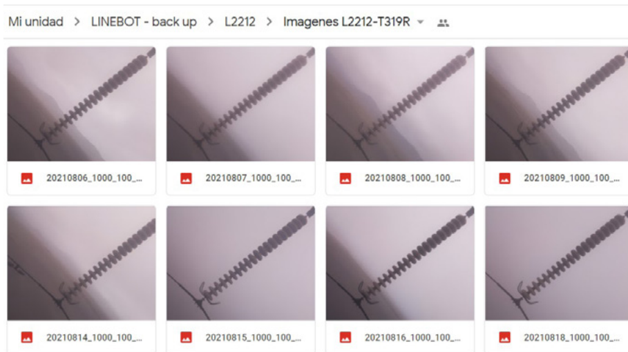
Figura 19. Fotos de aisladores de la línea 2212 desde LISA. Fuente propia.
