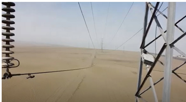
Figura 20. Fotos de LISA con sensores para cadenas instalado en la torre 319, L-2212. Fuente propia.
