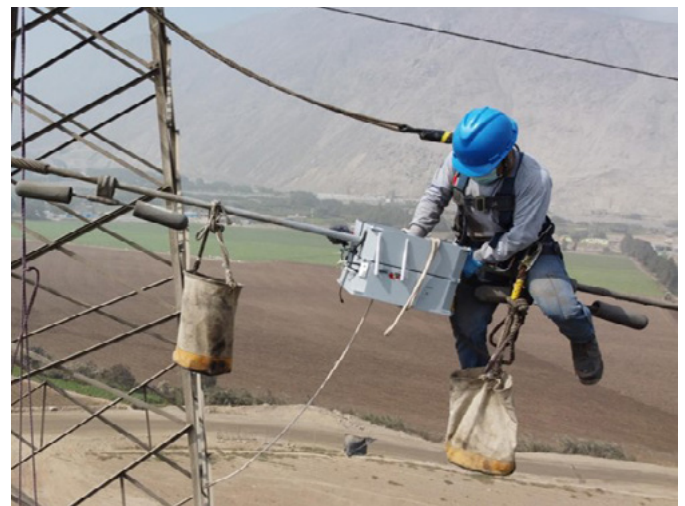
Figura 17. LISA en líneas de 220 kV, L-2212. Fuente propia.
