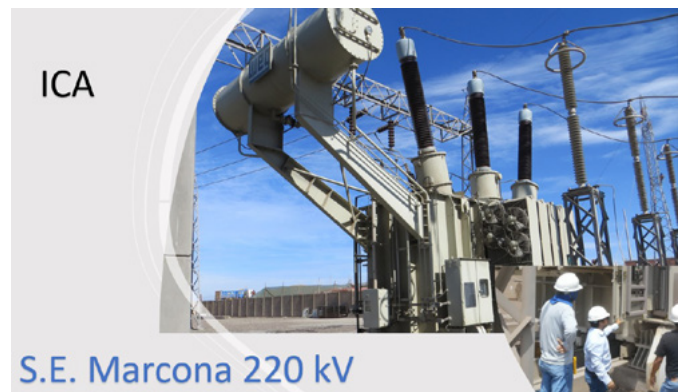
Figura 13. Instalación de LISA en SE Marcona. Fuente propia.
