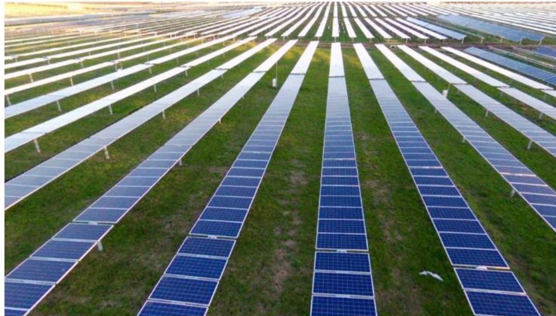
La planta fotovoltaica Del Litoral, en Uruguay.
